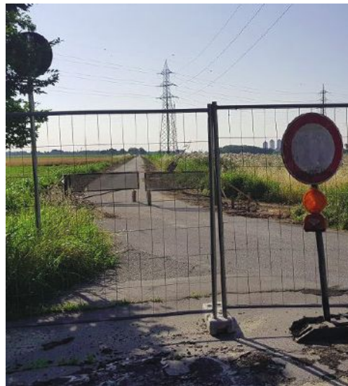
Cantiere fermo, operai assenti e nemmeno l'ombra delle ruspe sulla Cavallera.
