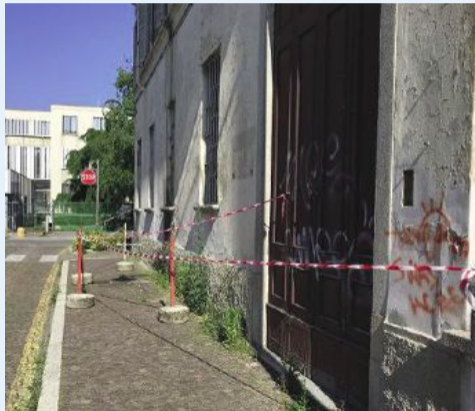
Il tratto di via Cereda transennato da alcuni giorni. A destra, parte del cornicione
