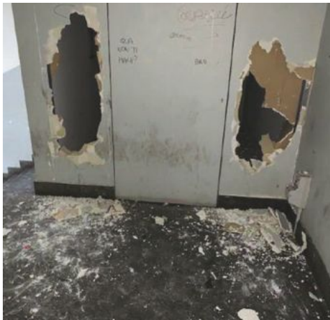
I danni causati in occasione dell'ultimo raid vandalico
