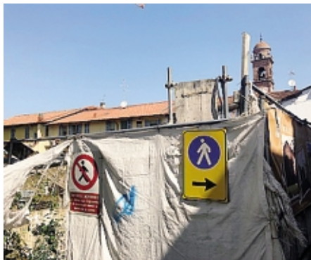
Il cantiere di via Vittorio Emanuele, in pieno centro storico, dove sono ripresi i lavori
