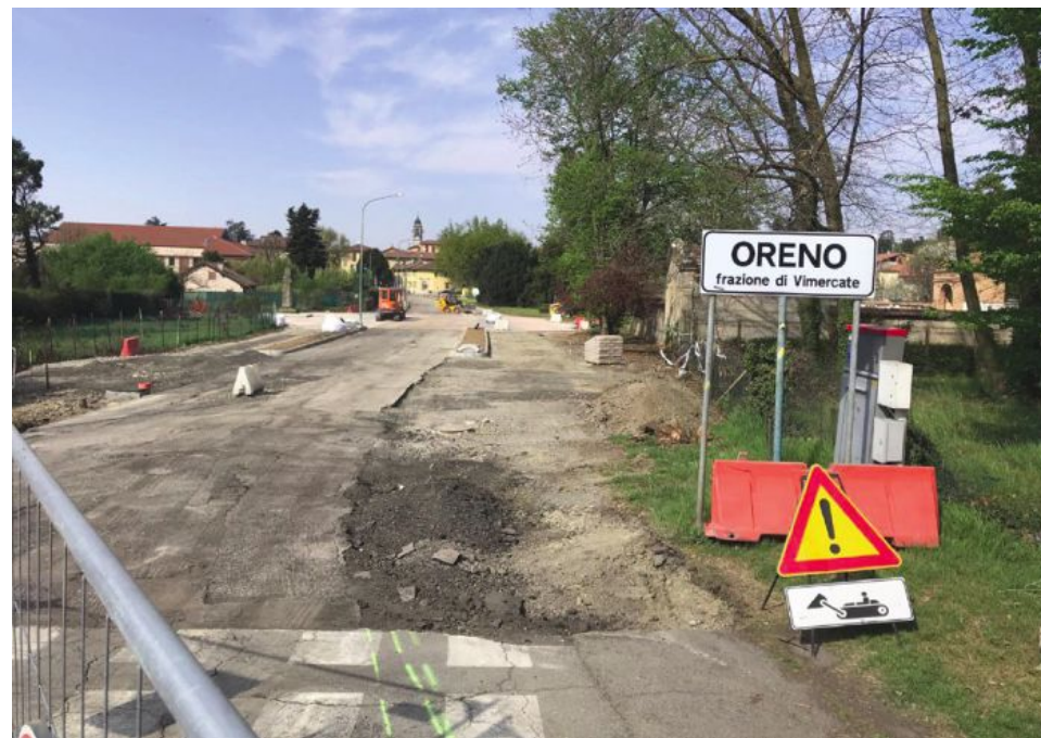
Il cantiere di via Rota in dirittura d'arrivo. Da sabato la strada sarà riaperta al traffico
